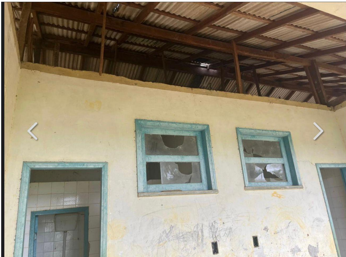
Figura 2 : Banheiro com porta e janelas depredadas e telhado com infiltrações; Fonte: Folha bv.
