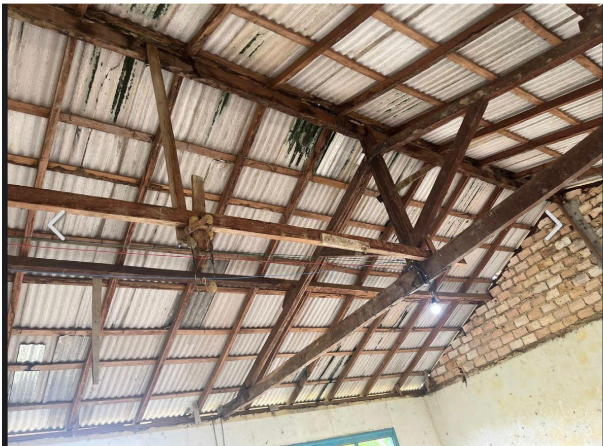
Figura 3: Telhado da escola apresentando sinais de deterioração.
