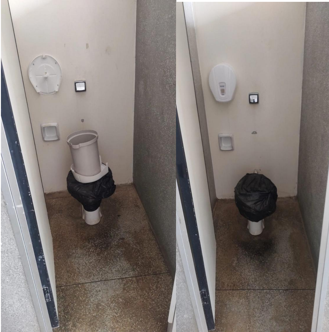
Figura 1: Situação dos banheiros da universidade; Fonte: Autor.
