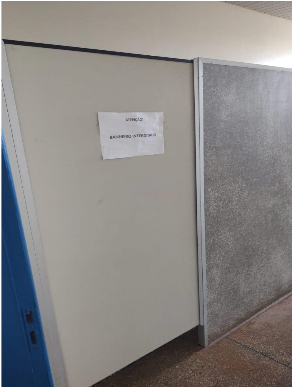
Figura 2: Banheiro interditado; Fonte: Autor.
