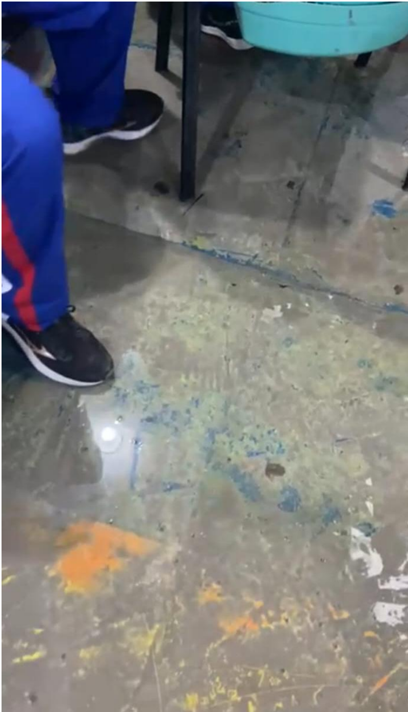
Figura 3: Fonte: Folha de Boa Vista; chuva adentrado as salas de aula temporárias na quadra de esportes
