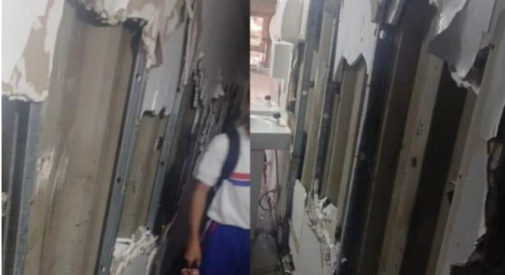
Figura 2: Fonte: Folha de Boa Vista; Situação da infraestrutura da escola.
