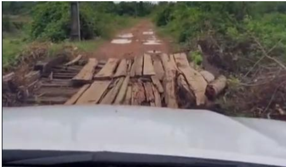
Figura 2: Ponte apresenta sua estrutura completamente danificada. Fonte: Instagram.
