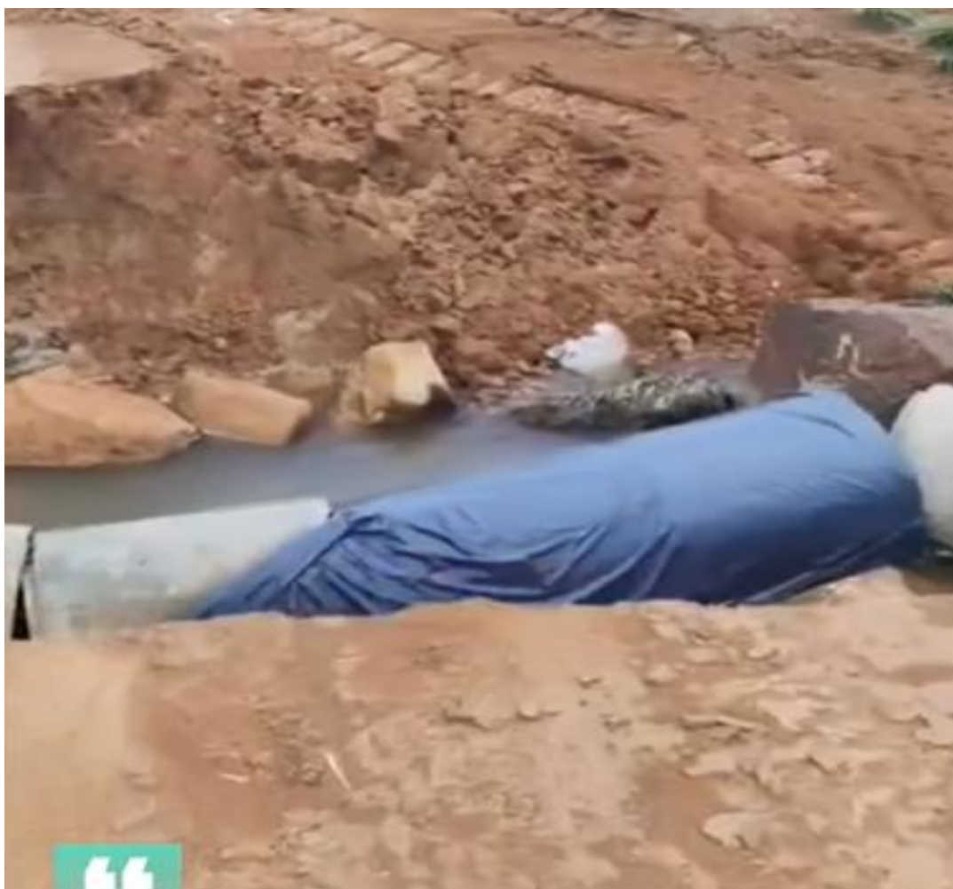
Figura 3: Desvio usado para passagem de veículos e pedestres destruído. Fonte: Instagram
