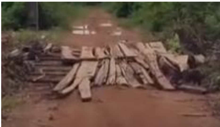
Figura 1: Ponte apresenta tábuas solta e justaposta sobre estrutura. Fonte: Instagram
