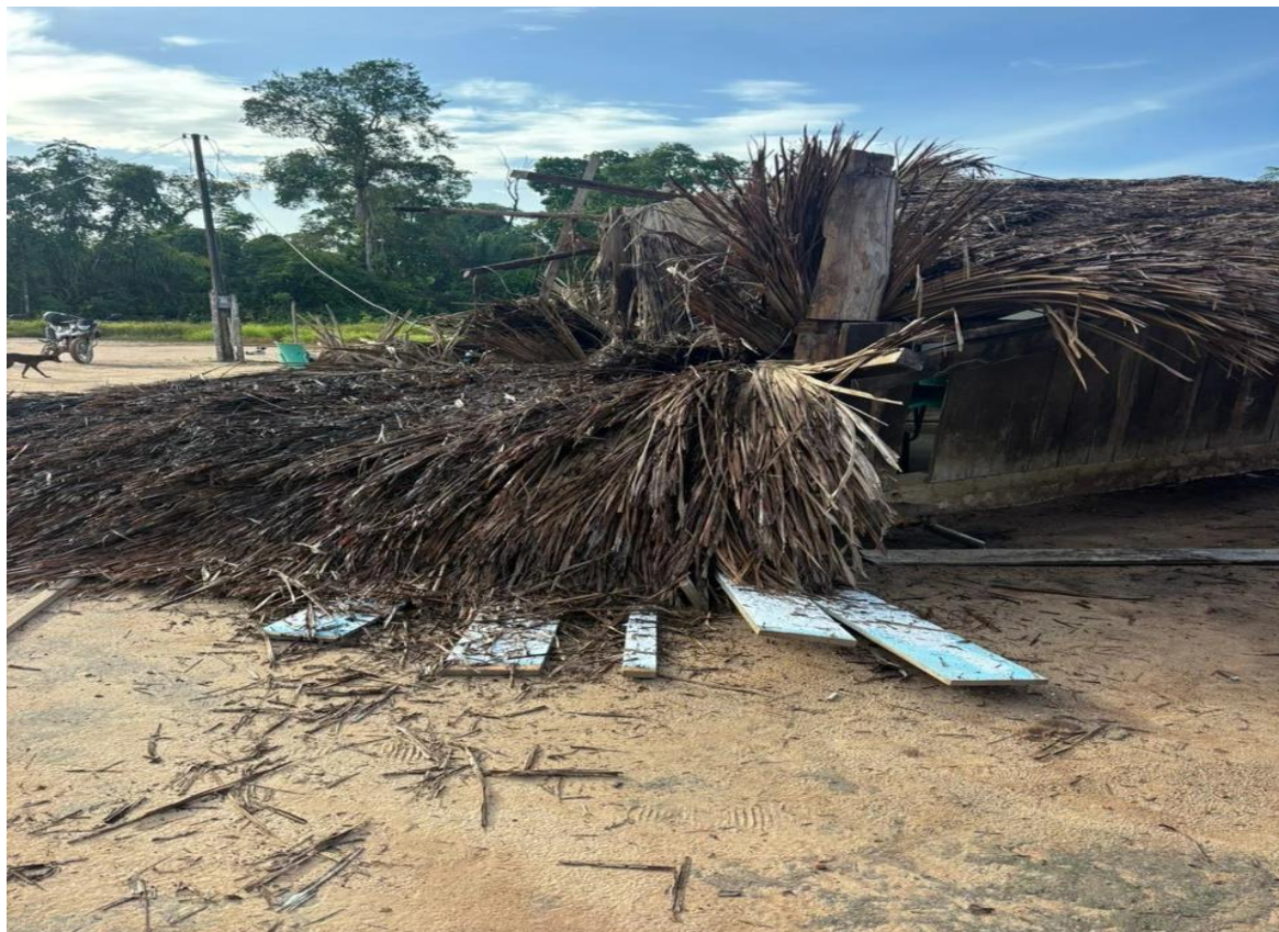
Figura 1: Cobertura da Escola Estadual Indígena Reinaldo Prill desabou devido fortes chuvas na região; Fonte: Reprodução.
