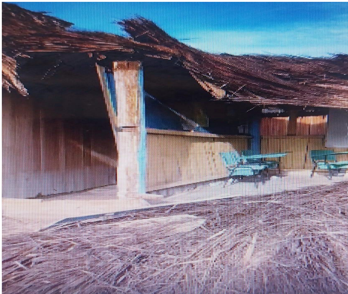
Figura 2: Cobertura de palha desabou devido as fortes chuvas na região do município do Cantá; Fonte: Reprodução.
