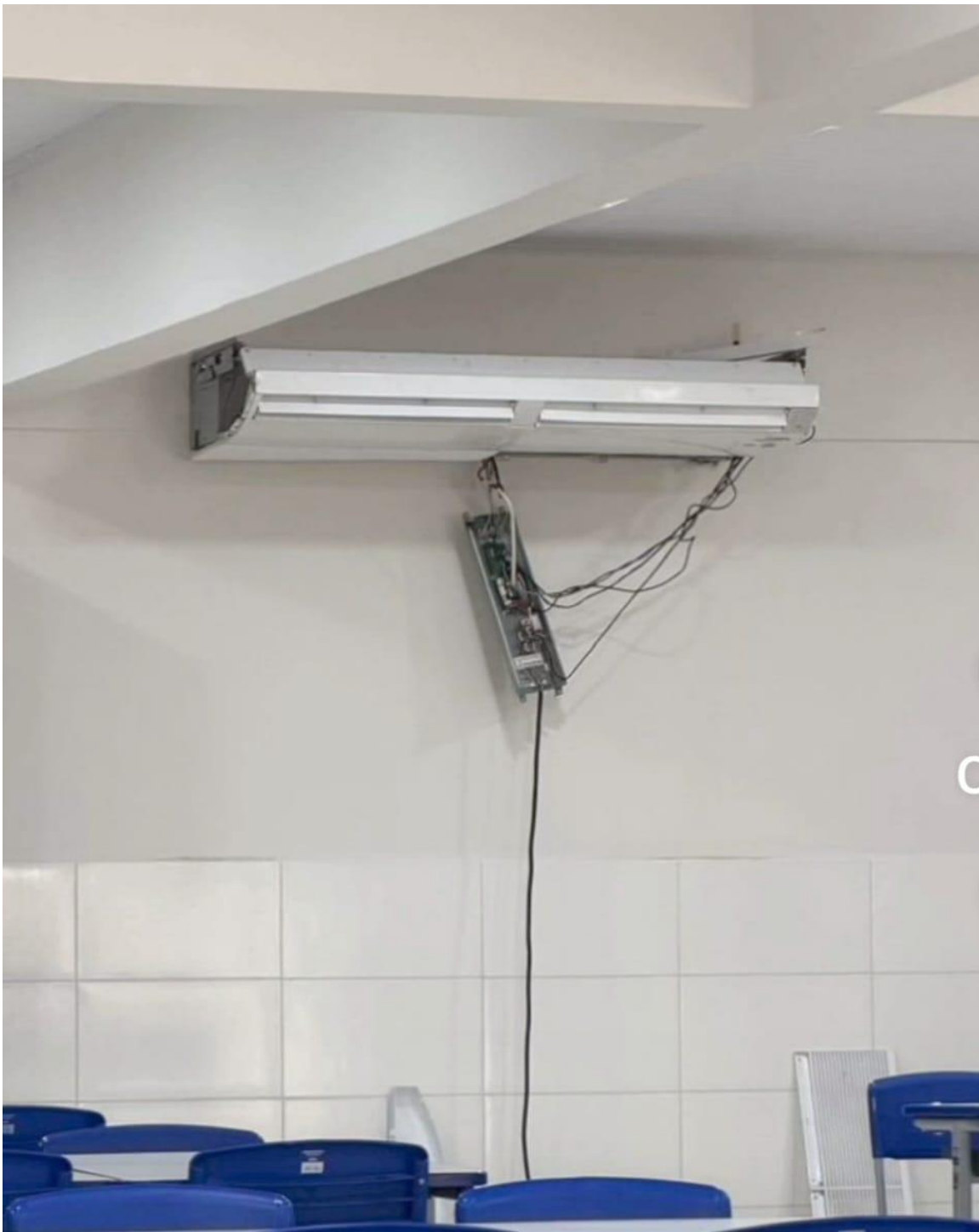
Figura 2: Parte da central de ar- condicionado caindo e com a fiação elétrica aparecendo. Fonte: Reprodução.
