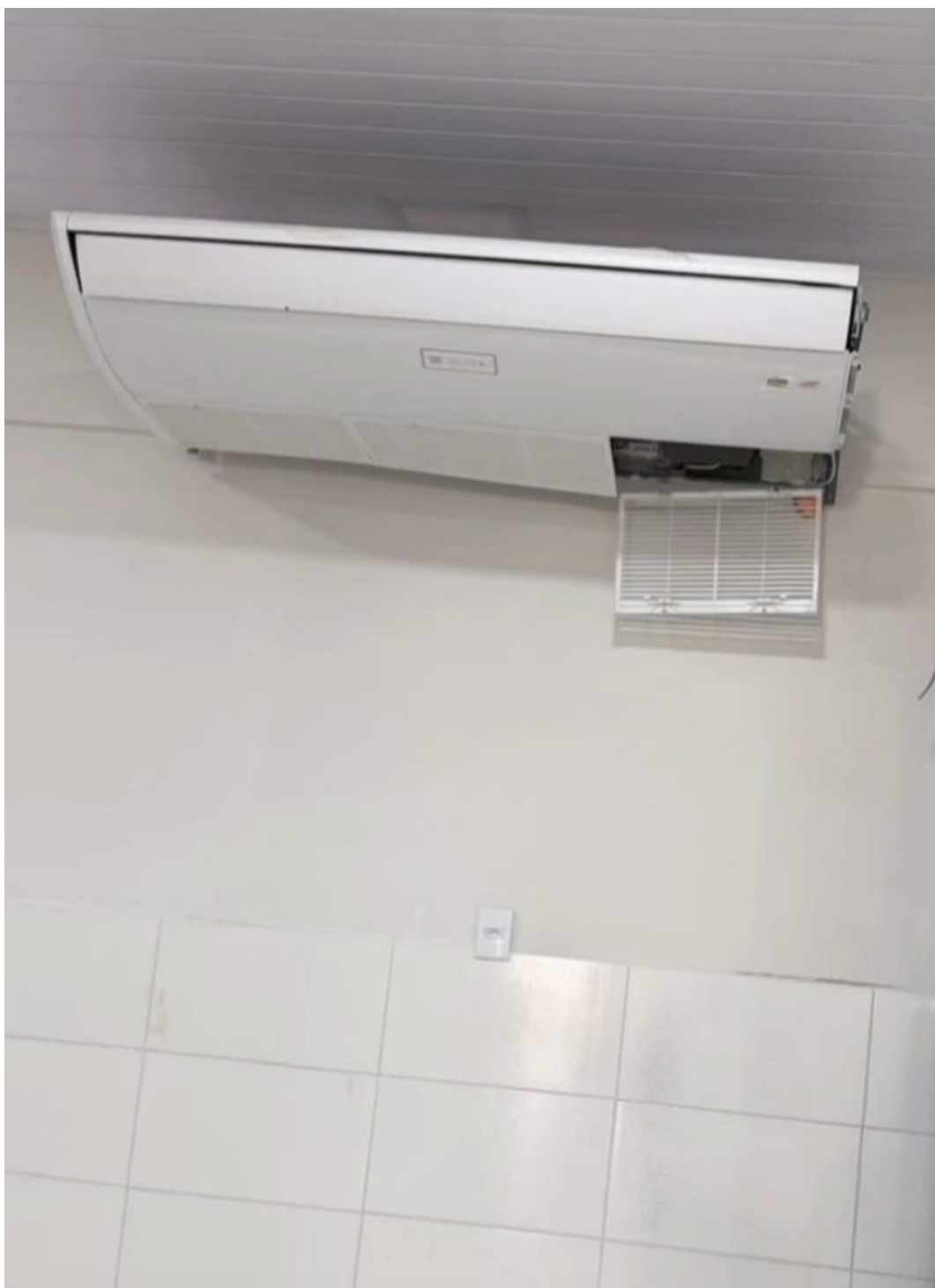
Figura 1: Placa de central de ar-condicionado caindo e quebrada. Fonte: Reprodução.
