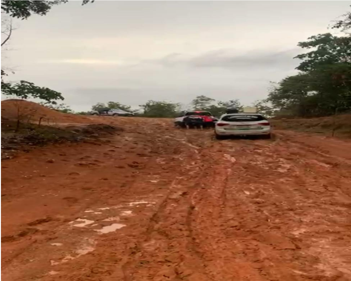
Figura 1: Parte da Estrada com desvio lamas e terras escorregadias devido as chuvas; Fonte: o autor.
