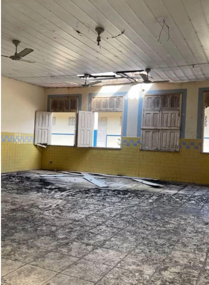
Figura 3: Janelas de madeiras quebradas, chão completamente coberto com poeira; Fonte: @bocadosul_rr.
