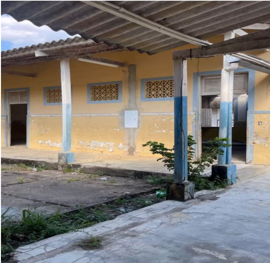
Figura 2: Salas sem portas, colunas fragilizadas com presença de cupim; Fonte: @bocadosul_rr.
