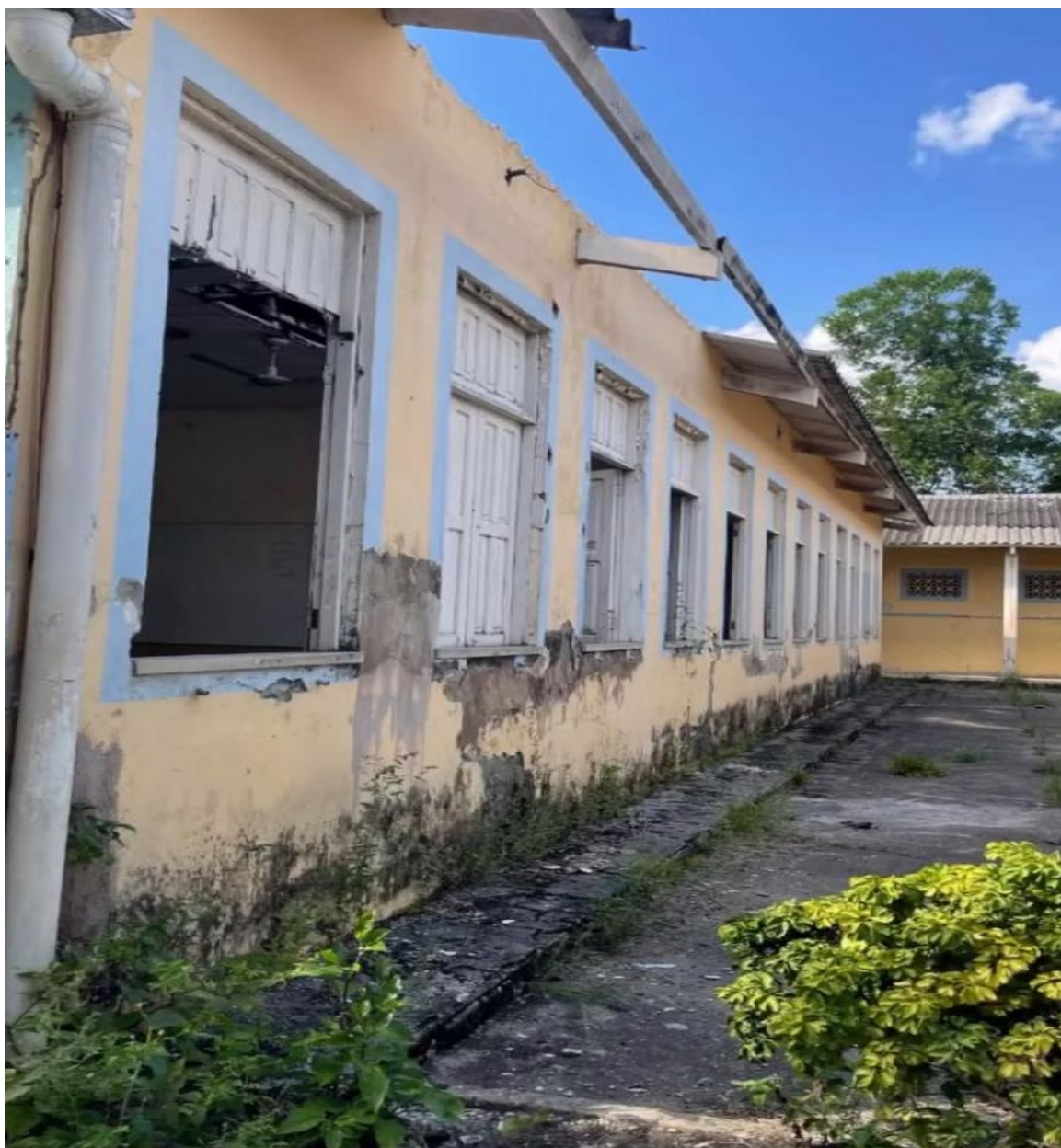
Figura 1: Parte externa da Escola com Paredes completamente desgastadas e morfadas, sem janelas; Fonte: @bocadosul_rr.
