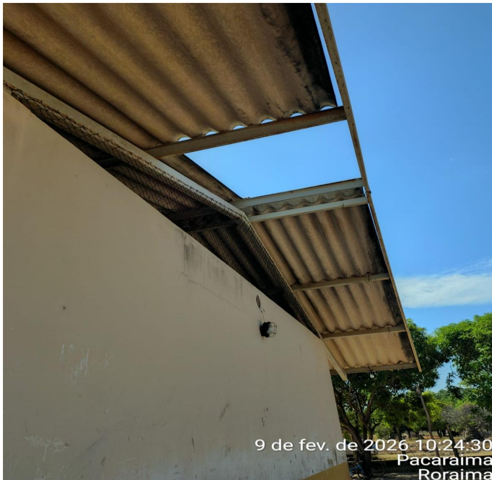
Figura 03: Telhado sem cobertura, faltando telha e parede descascan- do; Fonte: O au
