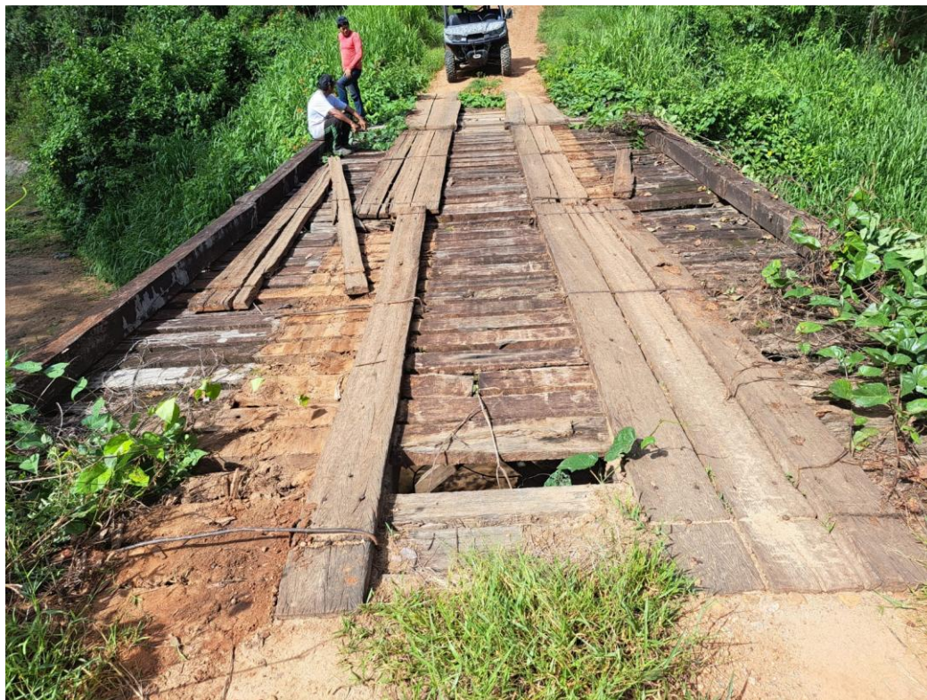
Ponte da Vicinal 239 (Pedra Branca), região do Paredão, no município de Alto Alegre (N 03°16'48.50" / O 061°34'39.20")
