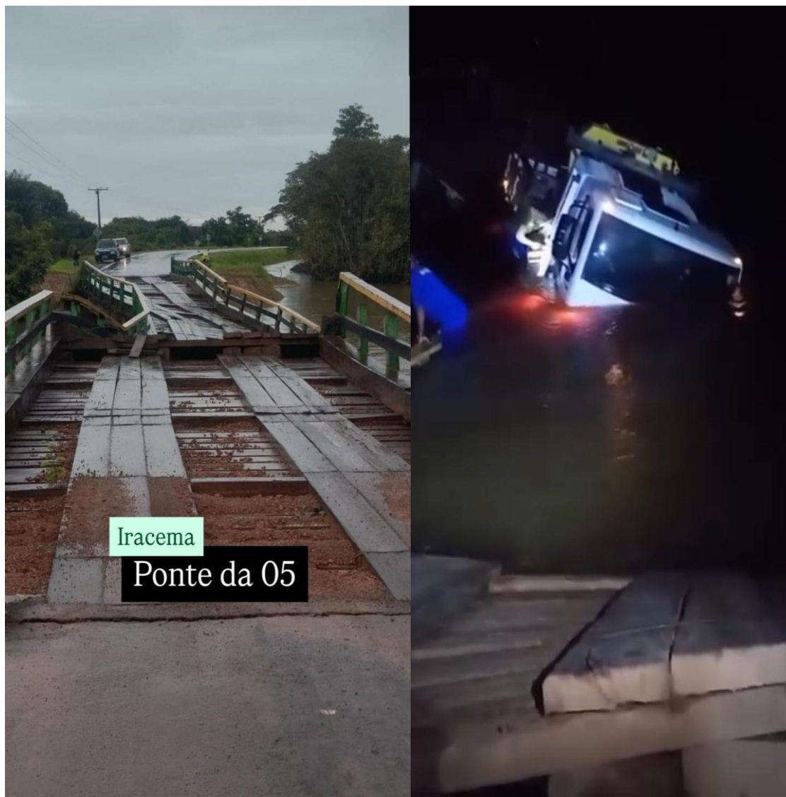
Ponte da Vicinal 05 (desbando)
