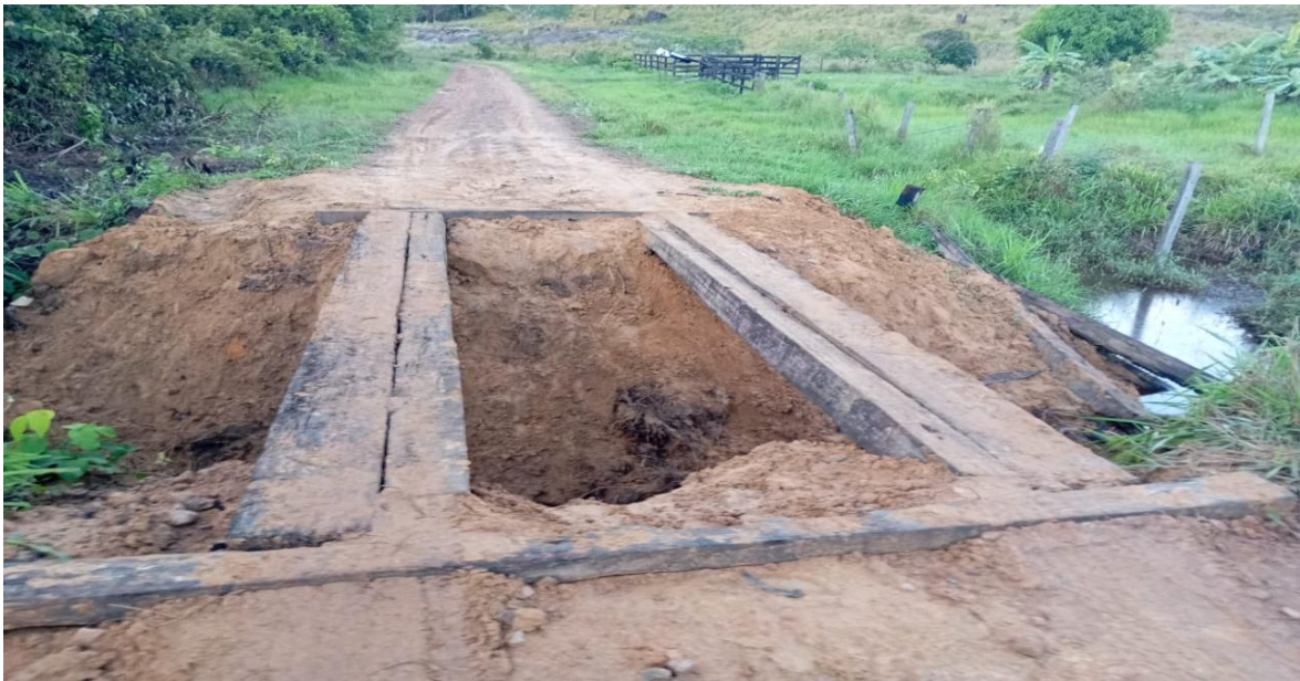
Foto 03. Ponte em situação de periculosidade.
