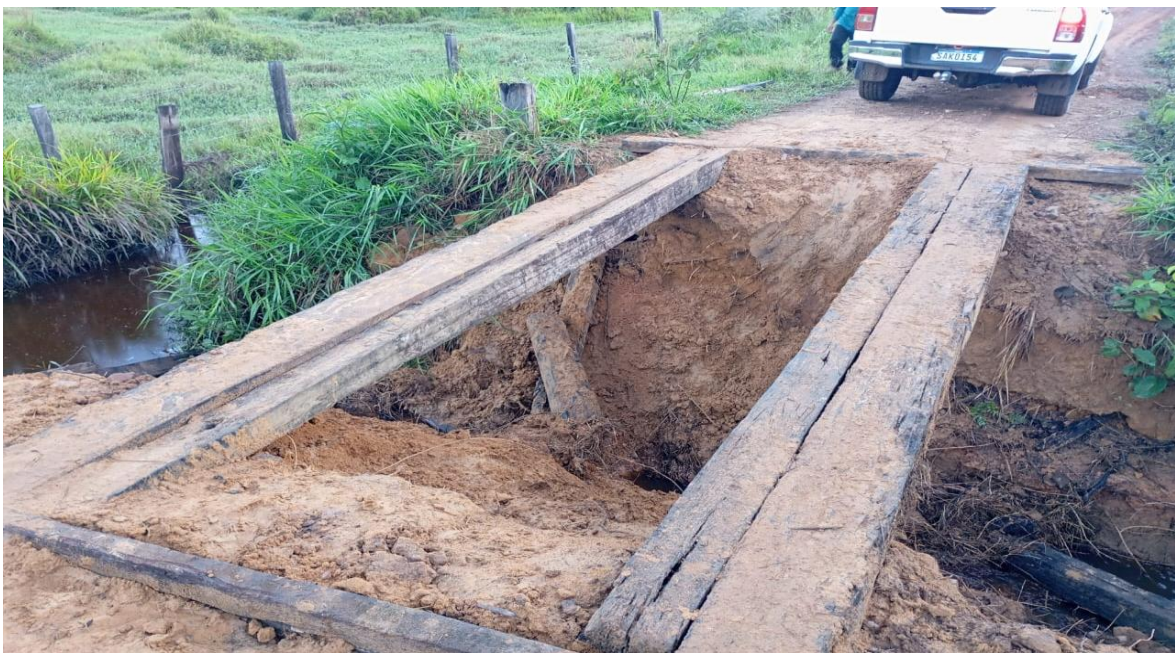
Foto 04. Ponte em situação precária.
