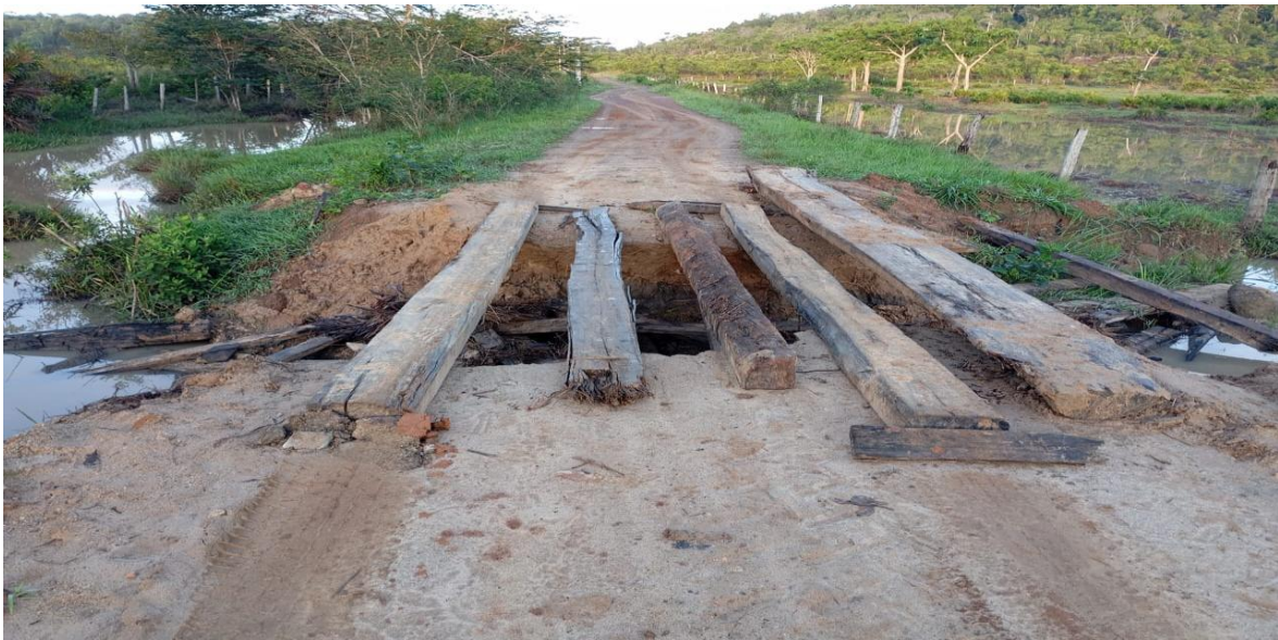
Foto 02. Ponte com troncos de madeira em situação precária.
