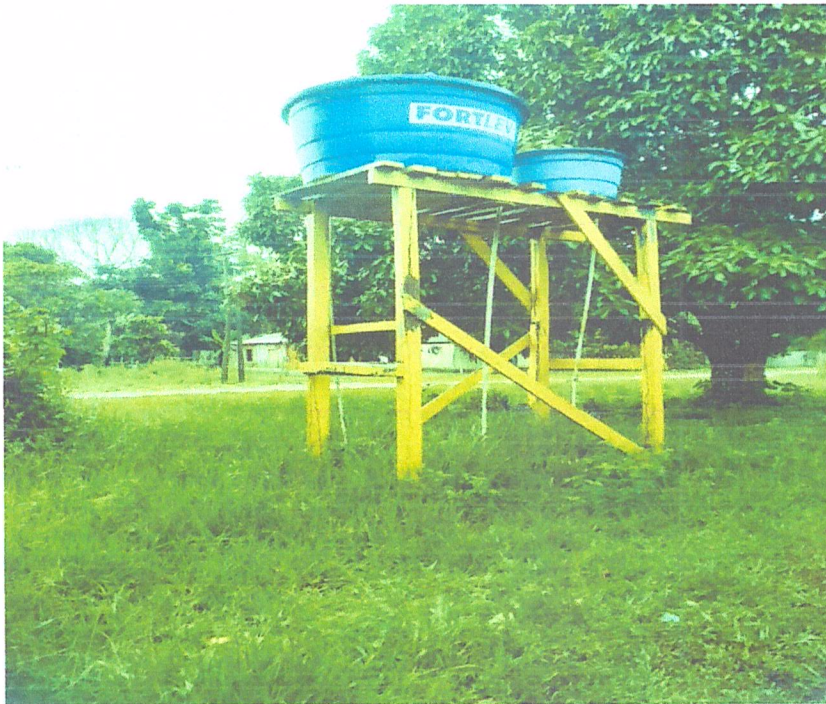
A estrutura de suporte das Caixas D'água está danificada devido a umidade e cupins.
