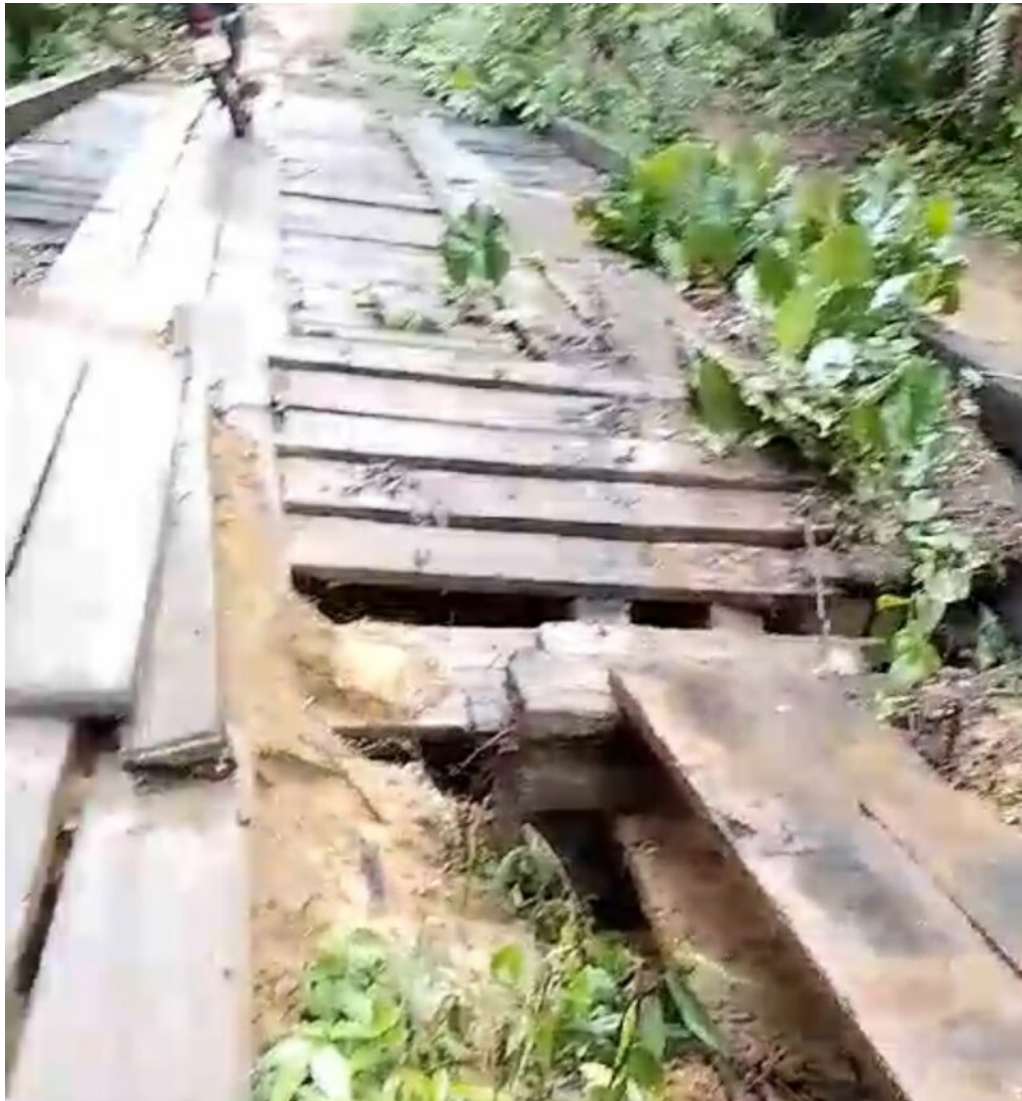
Foto 01 – Vista das más condições da ponte na vicinal.
