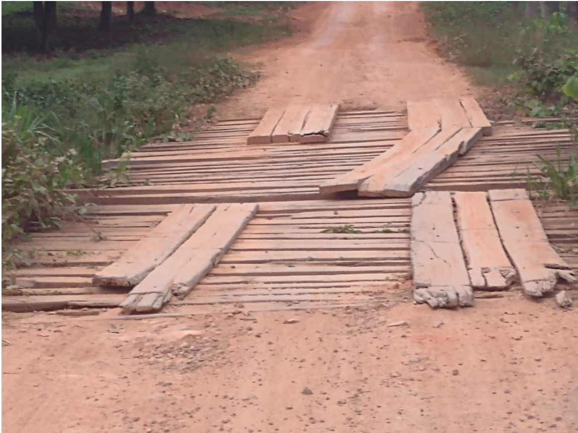
Figura 01: Ponte de madeira em péssimas condições. (Fonte: Dos Autores 2024)
