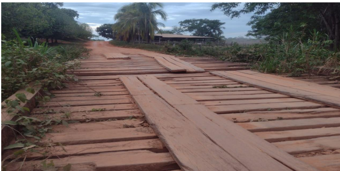
Figura 04: Ponte de madeira com madeiras soltas e sem proteção (Fonte: Dos Autores 2024)
