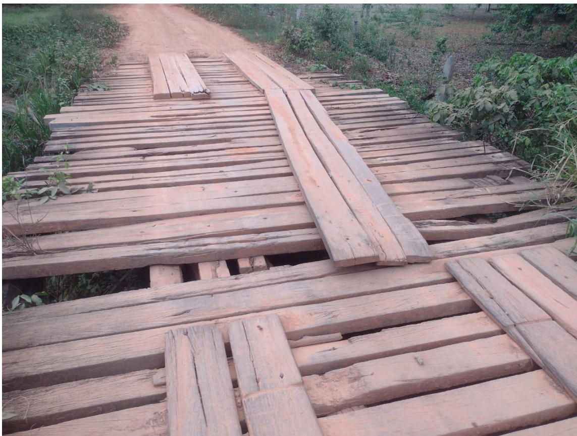
Figura 05: madeiras soltas com buracos e sem proteção. (Fonte: Dos Autores 2024)
